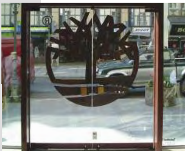
„Loop“-Installation – keine sichtbaren Antennen-Elemente
