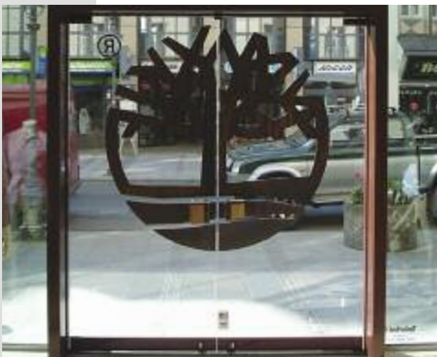
„Loop“-Installation – keine sichtbaren Antennen-Elemente
